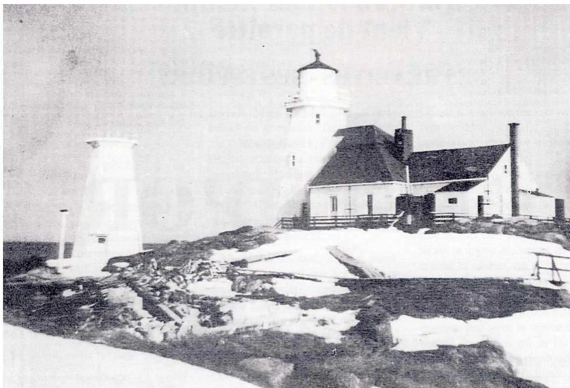
Vue du côté est de la maison-phare et de la tour du phare de l'Île-aux-Œufs avec le nouveau phare en béton en cours de construction en 1955.
